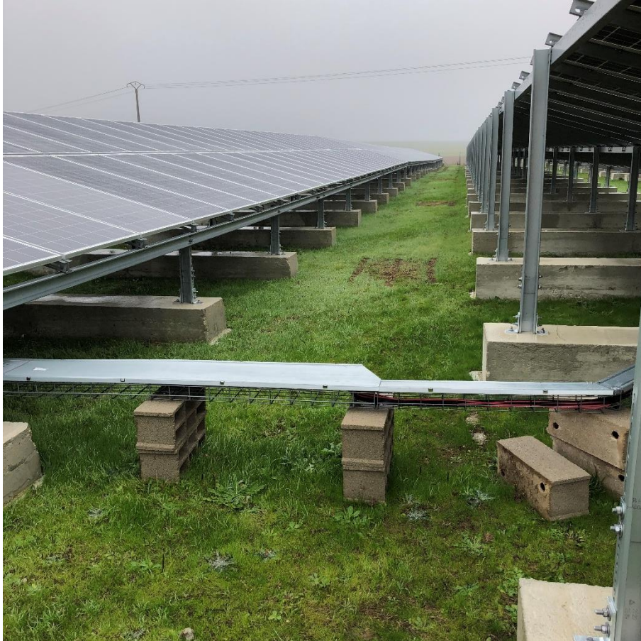
Exemples de câblages hors sol non intrusif
